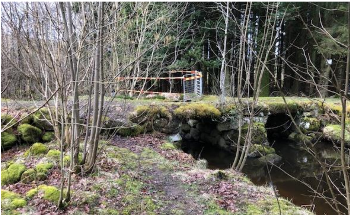
Gammel klopp over Frøylandsbekken. Farlig hull er merket med bånd
